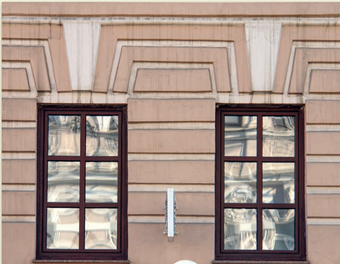
Рустовка и окна первого этажа дома фон Розена, фото А. Парамонова, 2020 год Die Rustika und Fenster des Erdgeschoßes des Hauses des Barons von Rosen. Foto: A. Paramonow, 2020
